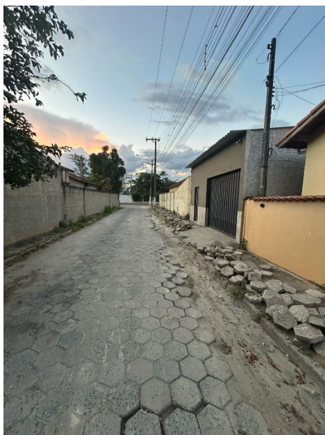
Rua Ferreira – Obra parada há meses e sem resposta da SABESP
